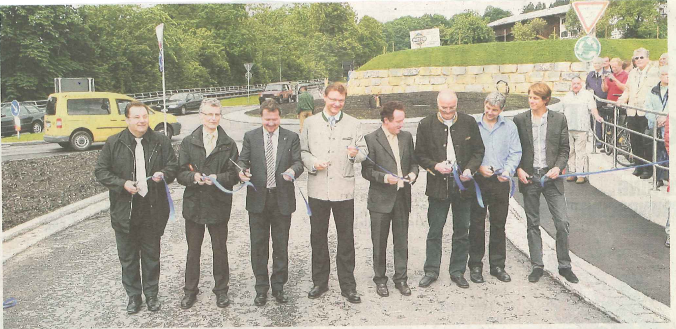
Sie durchschnitten symbolisch das Band und gaben der Kreisel damit gestern Vormittag für den Verkehr frei: Claus-Peter Olk, Leiter des staatlichen Straßenbauamtes, Reiner Essl, Baudirektor der Regierung von Oberbayern, CSU-MdL Klaus Stöttner, Bürgermeister Jürgen Seifert, Landrat Josef Neiderhell, Anton Schmuck, Geschäftsführer des Ingenieurbüros Dippold & Gerold, Projektleiter Jörg Huber von Dippold & Gerold sowie Helwig Falch, Bereichsleiter Tiefbau der Baufirma Swietelsky (von links).
